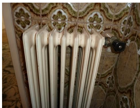
Heizkörper Bad ohne Thermostat
